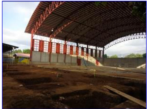
Vista panorámica donde se construirán las graderías. Observar la ejecución de las excavaciones de las fundaciones para gradería.
