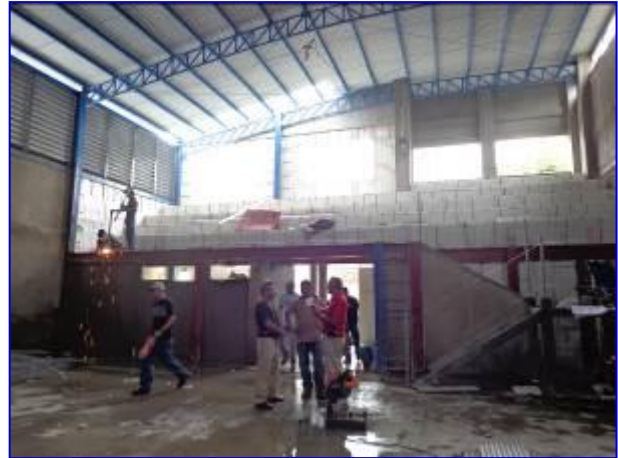
Vista interna (costado norte) de las instalaciones del Gimnasio de Boxeo. Observar la construcción con electropaneles y estructura metálica de las graderías y losa
