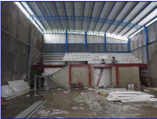
Vista interna (costado sur) del Gimnasio de Boxeo en Somoto, donde se aprecia la construcción de las graderías con electropaneles y estructura metálica, losa de piso de concreto.
