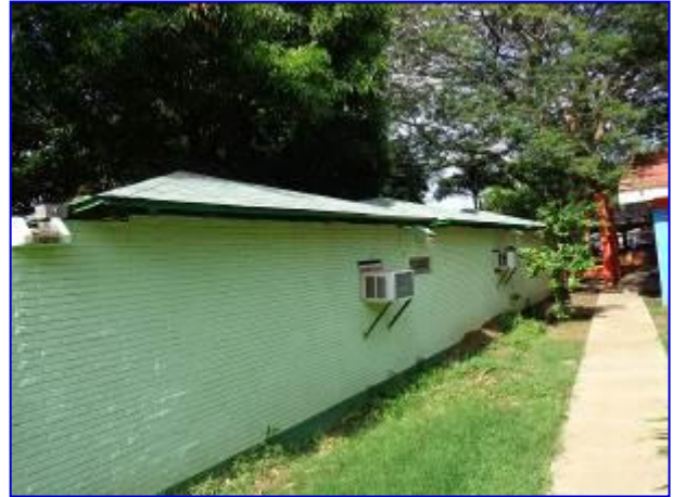
Apreciar el reemplazo de la cubierta de techo del edificio de Asesoría Legal y Delegaciones Territoriales.
