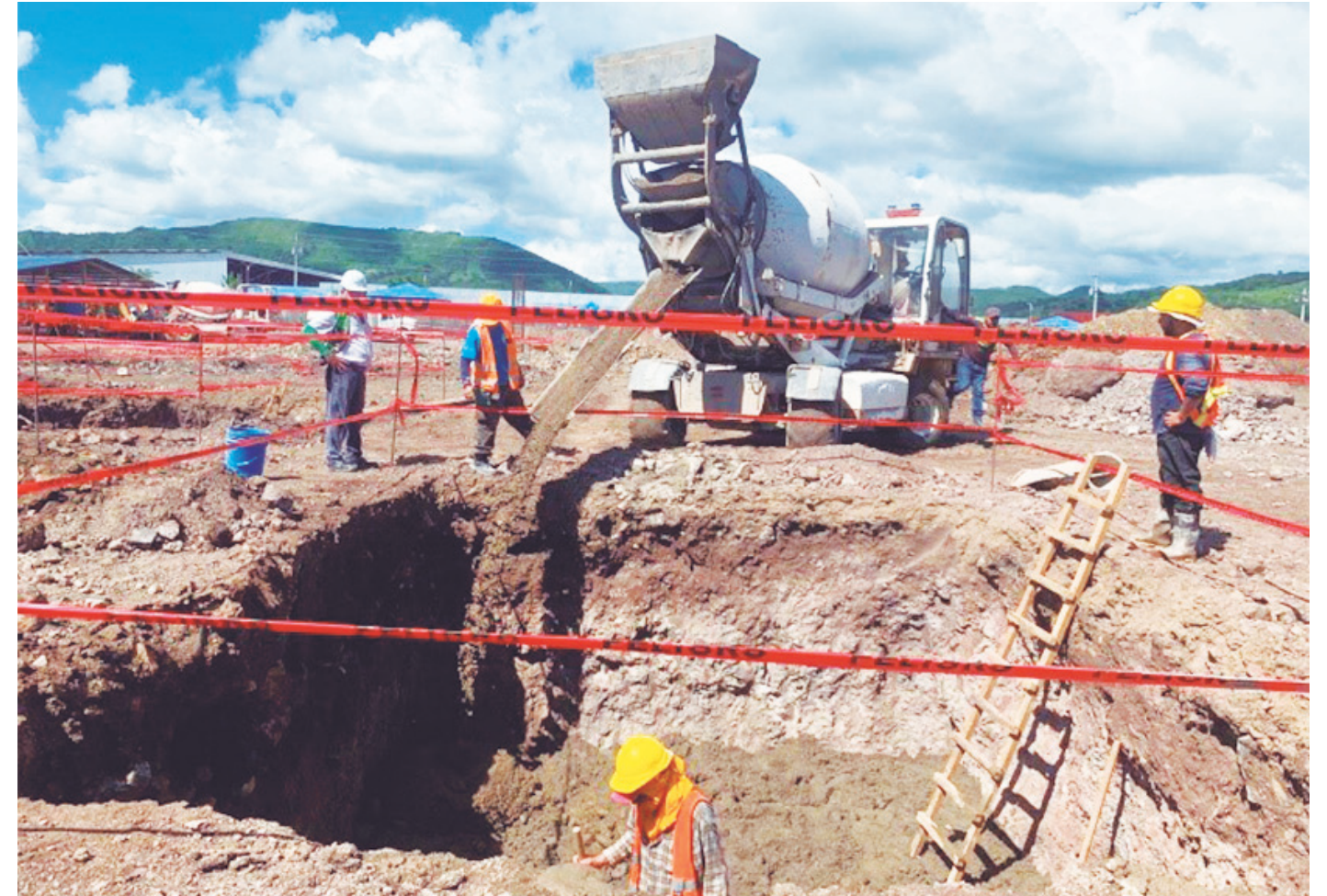
Llena de lodo concreto para garantizar el aislamiento de las zapatas (fundaciones) del suelo arcilloso.
